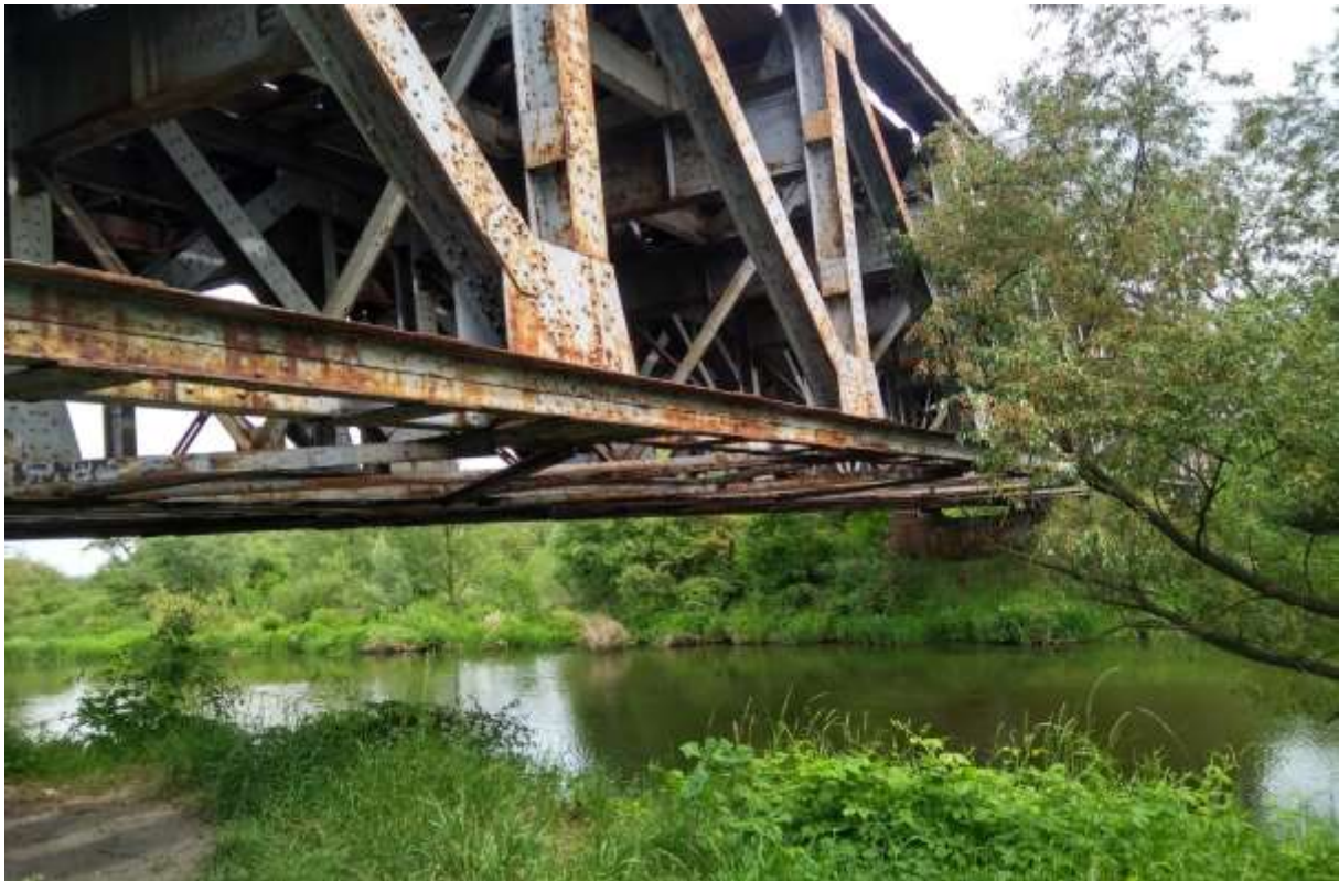
Rysunek 35. Most kolejowy z widocznymi szczelinami – ujęcie 3
