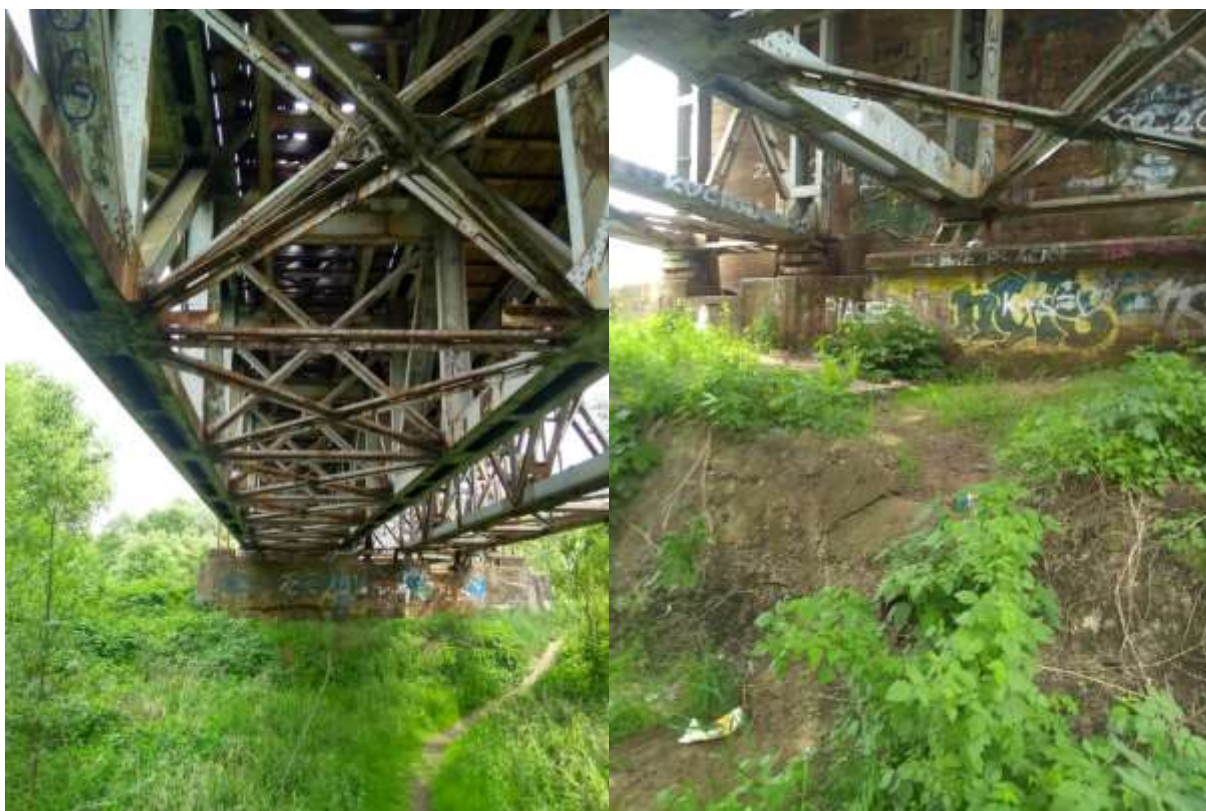
Rysunek 34. Most kolejowy z widocznymi szczelinami – ujęcie 1 i 2
