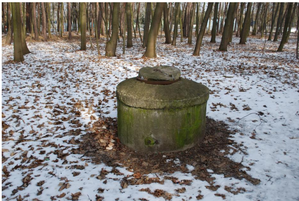
Rysunek 14. Studnia o złym stanie technicznym
