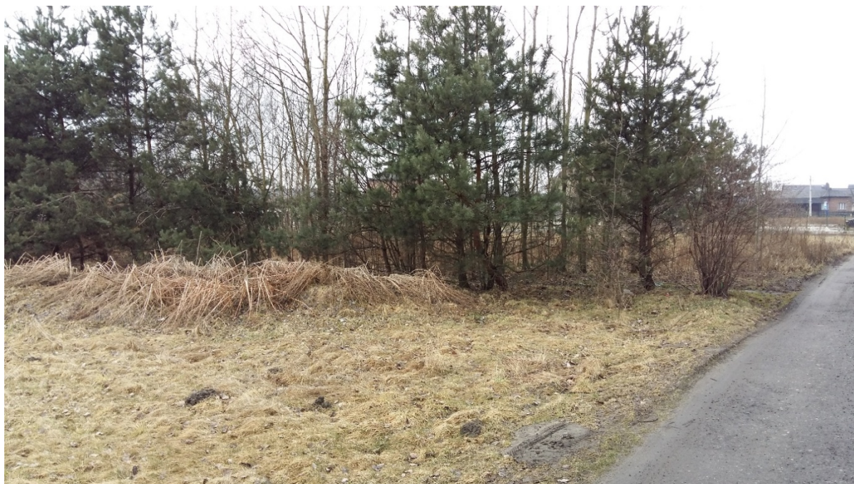
Rysunek 20. Zasypana część rowu melioracyjnego w rejonie ul. Kościelniaka
